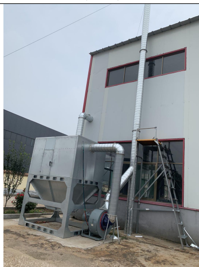
除尘器+排气筒
