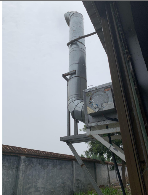
油烟净化器+排气筒
